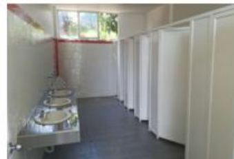
BATERÍAS SANITARIAS BLOQUE ZULIA VILLA DEL ROSARIO
